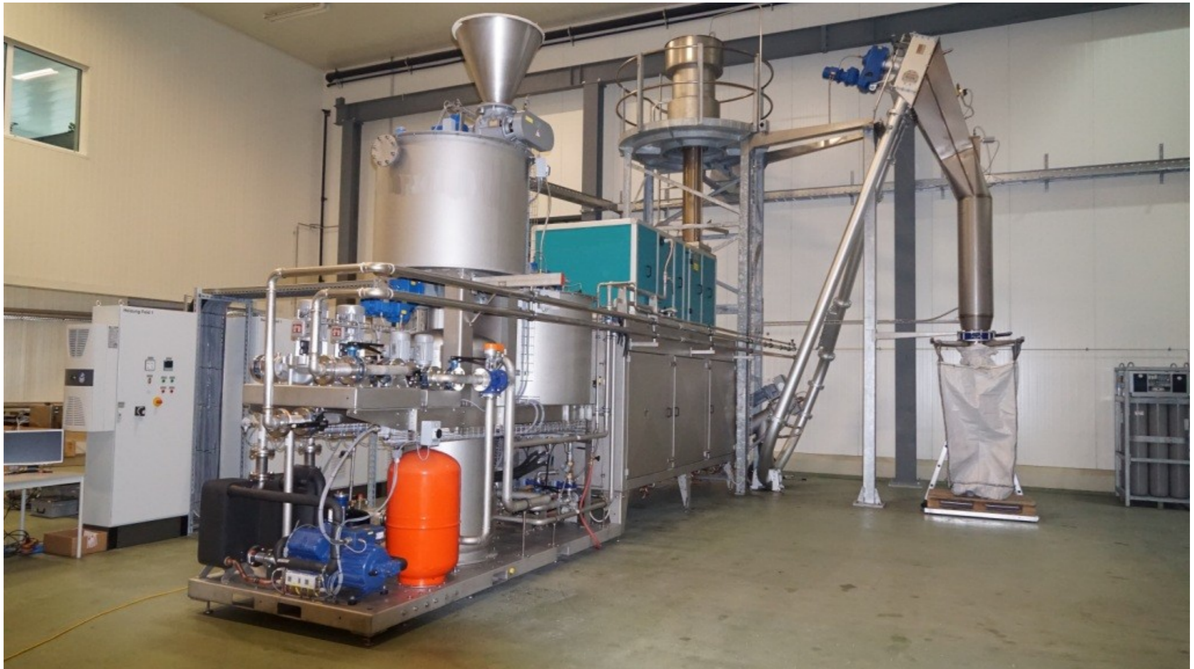
UHTH T5 Technikumanlage für Kundenversuche in der Schweiz
